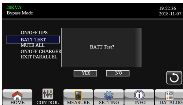
Figura 5.9 - Inicio del Test de Baterías
